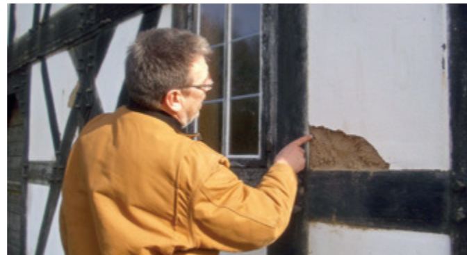
Ein anderes Haus steht im Museum an der falschen Stelle: Die Belastung durch Schlagregen führt in der exponierten Lage zu starken Putzschäden.
